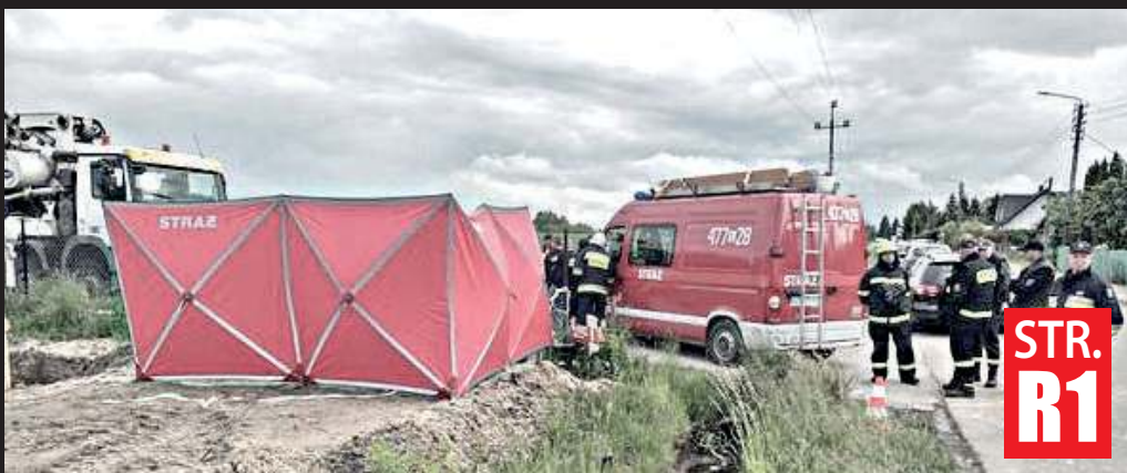
Podczas wylewania betonu operator pompy niefortunnie „zaczepił” o linie średniego napięcia. Mężczyźni, którzy w tym czasie trzymali pompę zostali porażeni prądem
