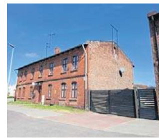
Lokatorzy kamienicy zostali wykwaterowani
