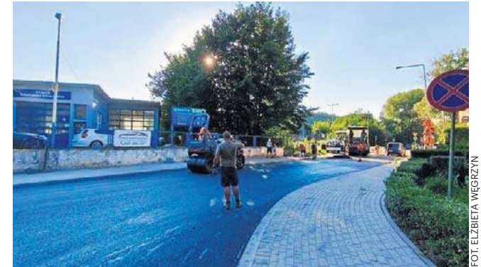
Gdy byliśmy na miejscu, układano już ostatnią warstwę mieszanki asfaltowej - warstwę ściernalną
