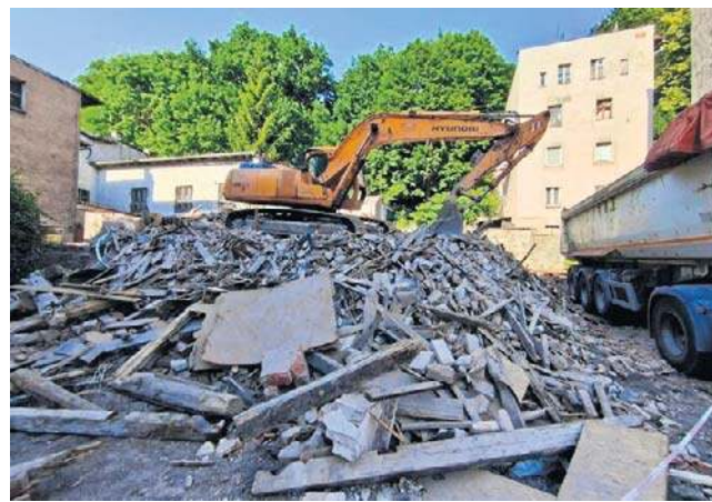
Budynek przy ul. Mickiewicza 9A nie był podpiwniczony, miał cztery kondygnacje, w tym strych
