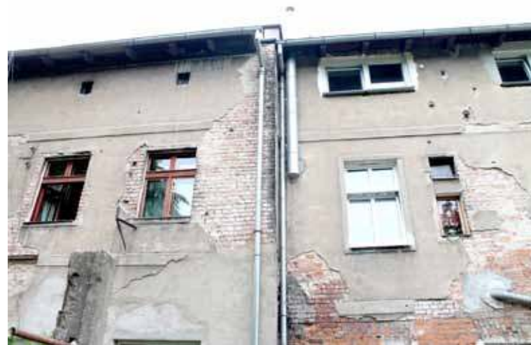
Tynk odpada płatami od ściany
