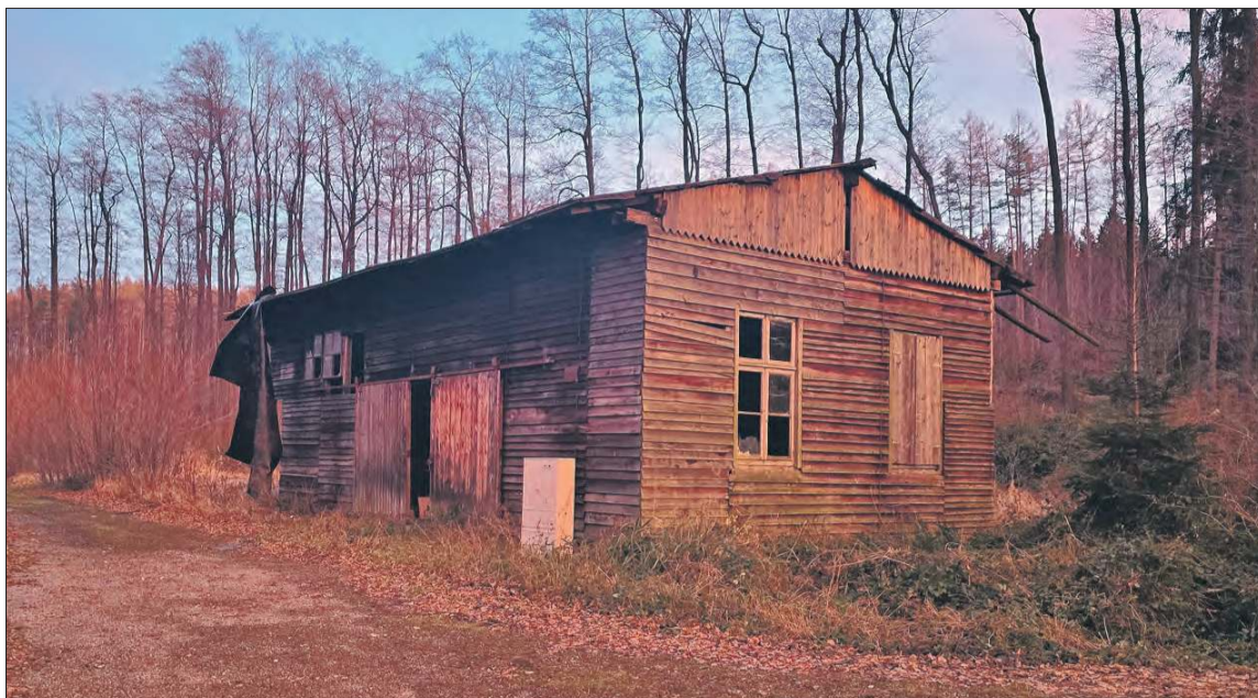
Część budynków ma lekką, drewnianą konstrukcję
