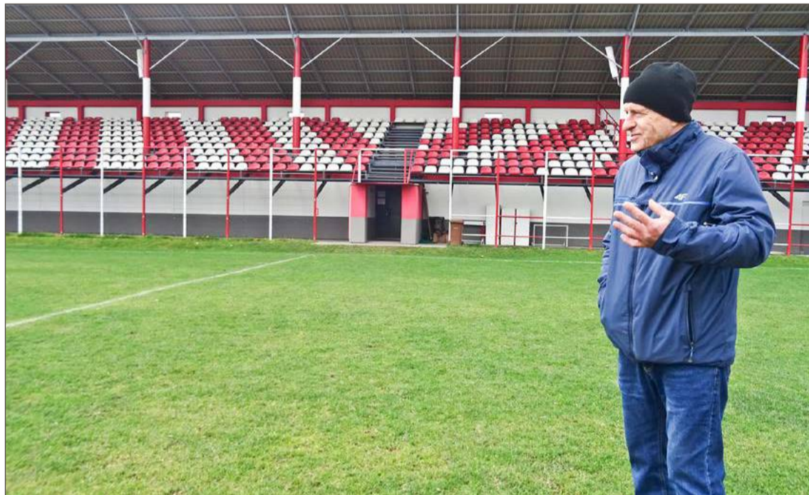
Jerzy Curyło chce, by na stadionie przy ul. Legionów wyremontowany został dach trybuny.
