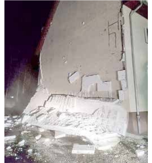
Wiatr dosłownie oderwał warstwę ocieplenia bloku przy ul. Bohaterów Warszawy na terenie osiedla POM
