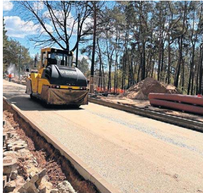
Prace na Rekreacyjnej trwają od niespełna 2 miesięcy. 1 maja przywrócono tam ruch samochodowy
