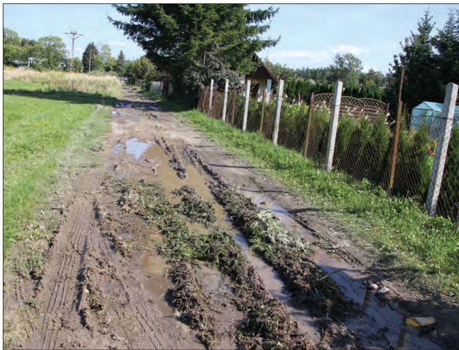
■ Droga dojazdowa do pól wzdłuż ogrodzenia ogródków działkowych jest w opłakanym stanie. Ktoś uznał, że dziury można uzupełnić badyłem
