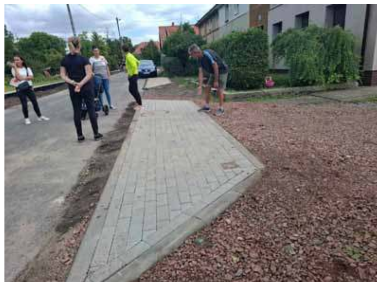
Mieszkańcy wskazują na mankamenty wykonawcze w postaci wysokich krawężników od strony ich posesji.
