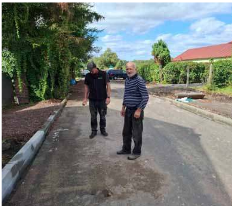
Pan Jan i pan Marcin wskazują m.in. na brak chodnika od strony ich posesji, wysoki krawężnik i to że skrzynka Enei znajduje się tuż przy jezdni
