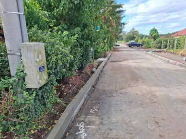
Zdaniem mieszkańców widoczna na zdjęciu skrzynka jest niebezpiecznie blisko jezdni, a brak chodnika spowoduje, że z podwórka wyjadą prosto na jezdnię. Ich zdaniem to kuriozum
