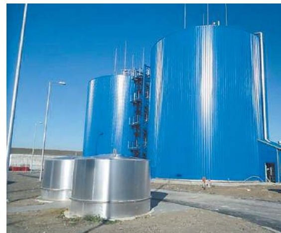
Zamknięte komory fermentacji wraz z klatką schodową oraz odsadczalnik biogazu.
