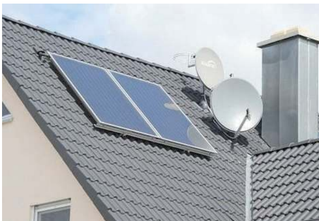
W ramach dwóch projektów w gminie Sitno zainstalowano już 815 instalacji solarnych.
