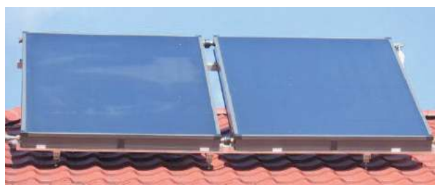
W 2019 r. w gminie Nielisz zamontowano 460 systemów solarnych oraz 80 systemów fotowoltaicznych.
