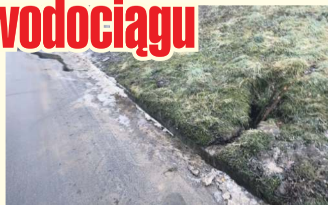
Tak wygląda miejsce wycieku przy ul. Polnej
