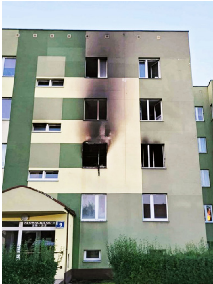
Tak wyglądał blok po pożarze
