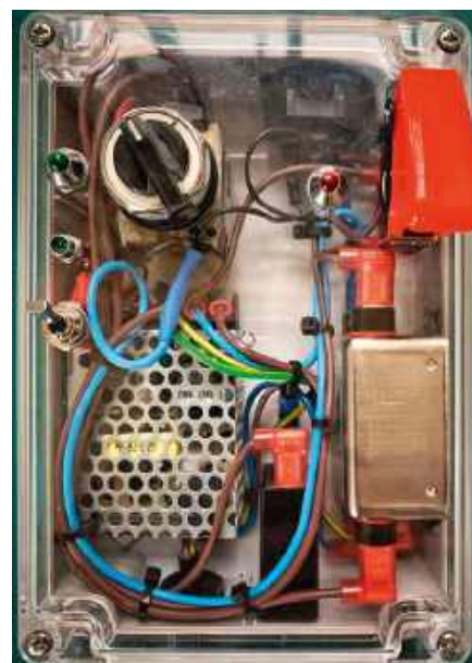
Zdjęcie 11. Skrzynka kontrolna cewki Tesli. Zawiera główny wyłącznik sieciowy, wyłączniki indywidualne wentylatora i transformatora, lampki kontrolne oraz inne elementy
