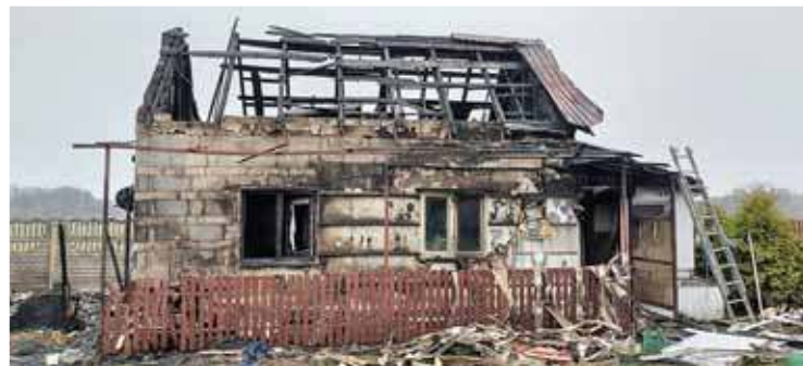
Straty spowodowane pożarem domu są bardzo duże
