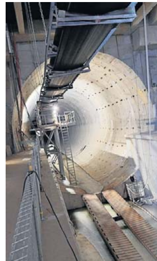
Drażnienie tunelu stoi od 16 miesięcy
