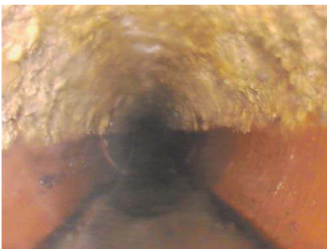
Oblepione olejem i tłuszczem rury kanalizacyjne
