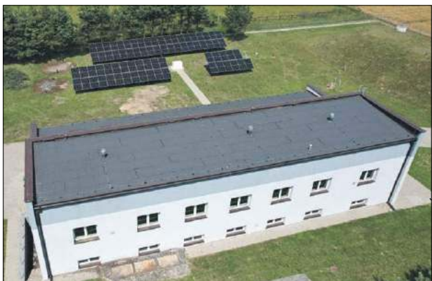
Na Spółdzielniach Usług Wielobranżowych w Milanowie i Rudzie montowane są instalacje fotowoltaiczne
