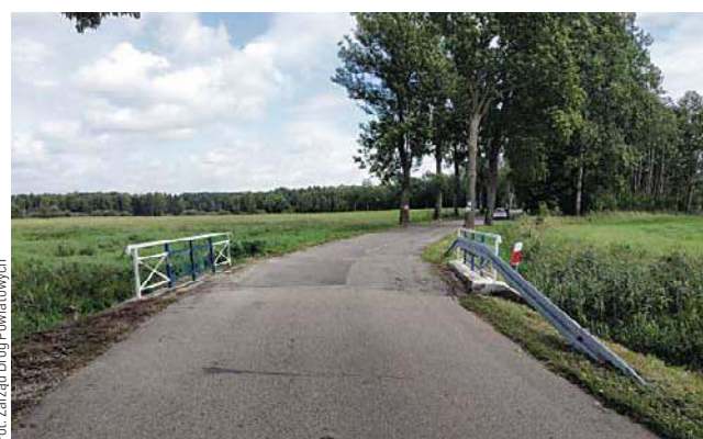
Złodzieje zabrali stalowe zabezpieczenia na moście niedaleko wsi Szczepanki
