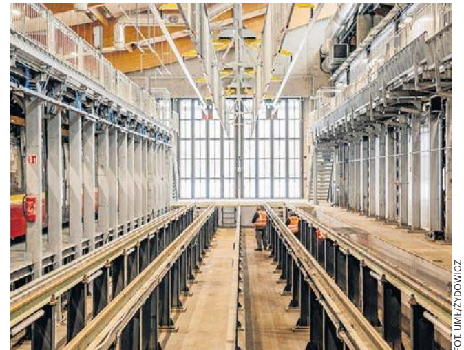
To tu pojazdy sprawdzane są pod kątem technicznym, uzupełniane są płyny eksploatacyjne oraz piasek
