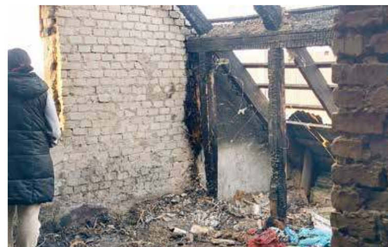
Wnętrze, które uległo zniszczeniu
