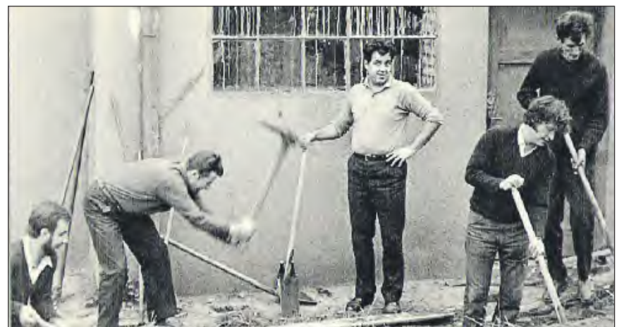
W pracach społecznych przy budynku warsztatów szkolnych brali udział również nauczyciele. Od lewej: Jerzy Zieliński, Henryk Wiejak, Mieczysław Tuwalski, Jerzy Chiciński, Waldemar Smaga
