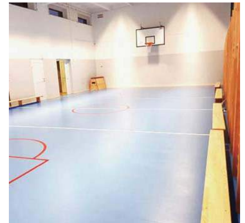
Sala sportowa przy SP3 przed remontem nie była remontowana od 40 lat
