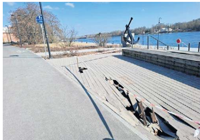
Koszty remontu zostaną w całości pokryte z ubezpieczenia kierowcy, który wjechał na podest
