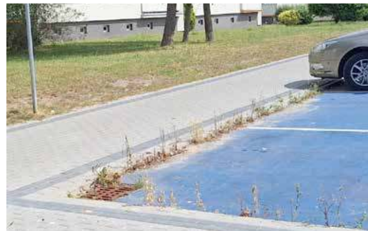
Porośnięty chwastami parking przy ul. Stefana Żeromskiego
