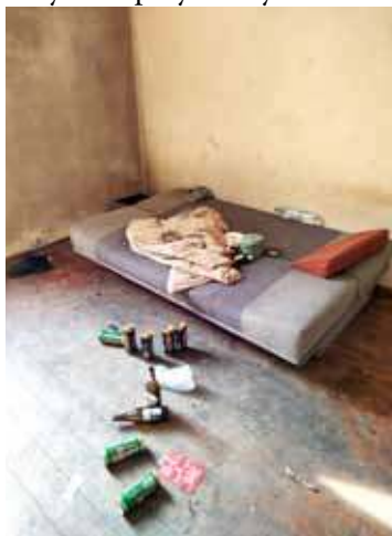
Jak widać pomieszczenie nadaje się do gruntownego remontu
