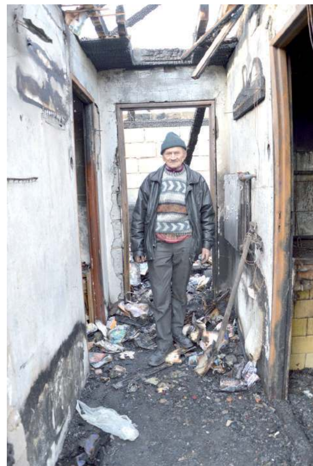
W domu znajdowały się kuchnia, łazienka oraz pokój i przedpokój. Wszystko niemal doszczętnie strawił pożar. - Nawet grzejnik na ścianie się stopił. Jakaż to musiała być temperatura! - mówi pogorzelce. Przed murowanym budynkiem był drewniany ganek. Nic z niego nie zostało
