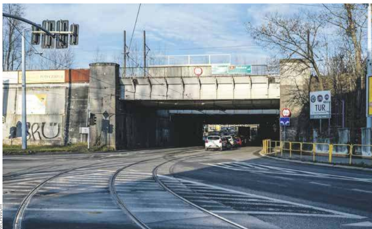
Stary wiadukt od dawna nadawał się do wyburzenia
