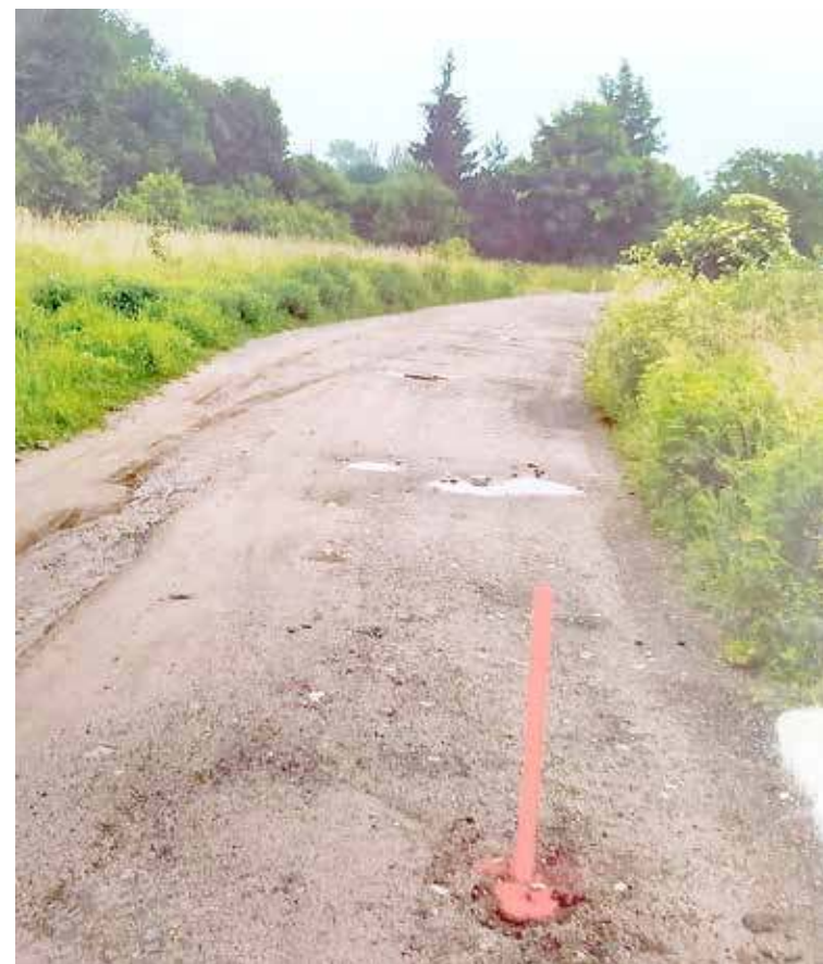
Prawie cały przebieg drogi gminnej na odcinku ok. 80 metrów leży w obrębie prywatnej działki
