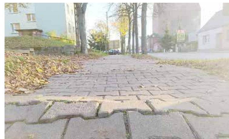
Korzenie drzew coraz mocniej wypychają kostkę, w wyniku czego tworzą się niebezpieczne wybrzuszenia
