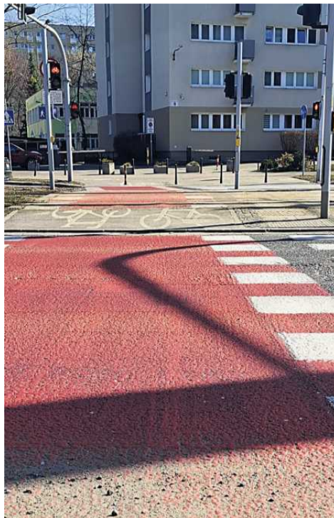
• Warszawa, Al. Reymonta: centymetrowy ryzshtok, krawężniczek, garby przy szynach, kolejny ryzshtok i krawężniczek.
