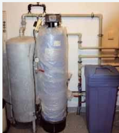
Filtry i zmiękcacz zamontowano za zbiornikiem hydroforowym, w kotłowni.
