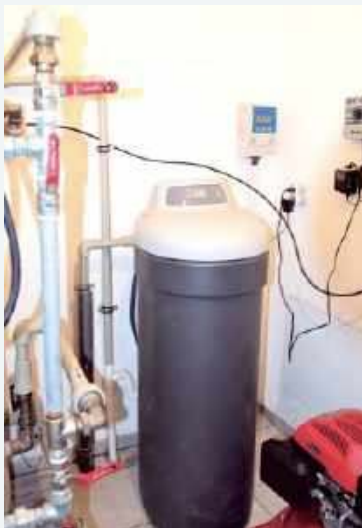
❶ Wodę z wodociągu uzdatnia urządzenie multifunkcyjne ze zmiękczaczem i automatyką.
