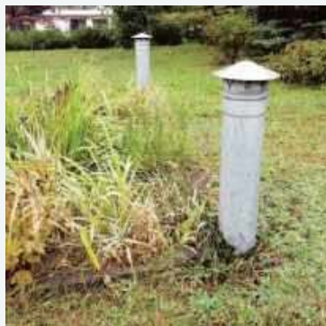
📍 Kominki napowietrzające na zakończeniu dwóch 20 m drenów.
