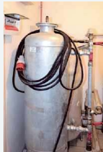
❷ Za hydroforem umieszczono filtr odżelaziający (dotyczy wody ze studni).
