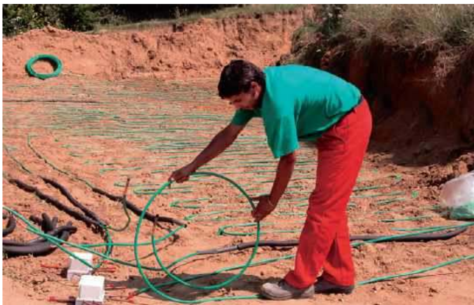
Źródło Kolektor gruntowy jest wydajnym i stabilnym źródłem ciepła dla pompy. SOFATH
