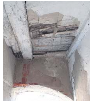
Nad wejściem od strony podwórka tynk sypie się na głowę.
