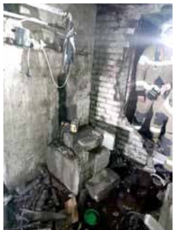
W wyniku zdarzenia uszkodzona została ściana działowa piwnicy. Foto. OSP. Stara Dąbrowa
