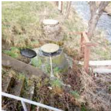
Zapchana przepompownia spowodowała wyciek ścieków do rzeki
