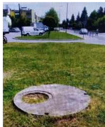
Betonowy właz od miesięcy leży na trawniku przy ul. Klonowej
