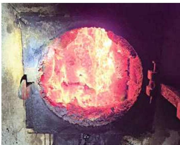
Pożar sadzy w przewodzie kominowym może być bardzo niebezpieczny
