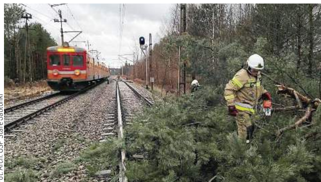
Wiatrolom zablokował tor kolejowy na linii Ostróda – Olsztyn
