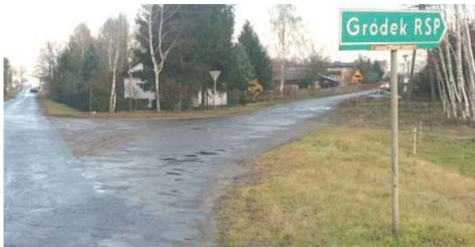
Droga jest w bardzo kiepskim stanie. W czasie opadów deszczu tworzą się kałuże. Pobocza ziemne są wyniesione, uniemożliwiają często odprowadzenie wody z jezdni
