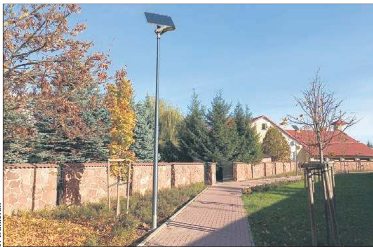
Zasilane bateriami słonecznymi latarnie zostały zamontowane przy ul. Norwida
