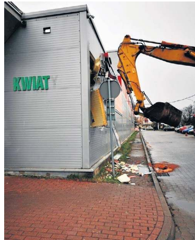
Złodzieje chcieli dobrać się do kantoru za tą ścianą....
