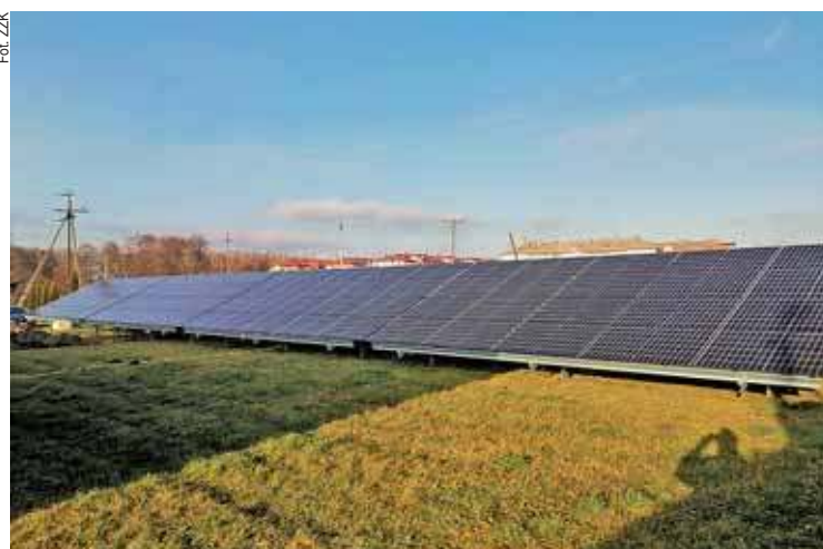
Nowa instalacja fotowoltaiczna zasila oczyszczalnię ścieków
