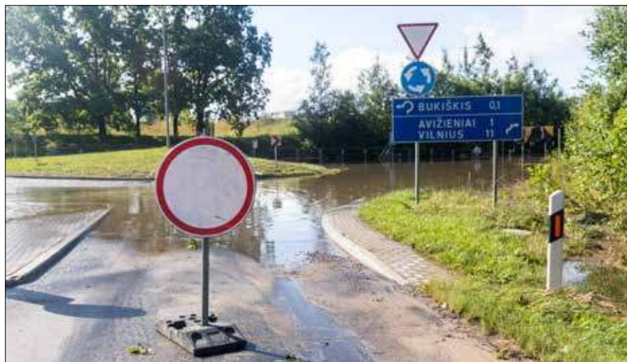
Próba przejazdu przez zalany odcinek drogi może zakończyć się poważnym uszkodzeniem samochodu. Fot. Gabija Šileikaitė, ELTA
