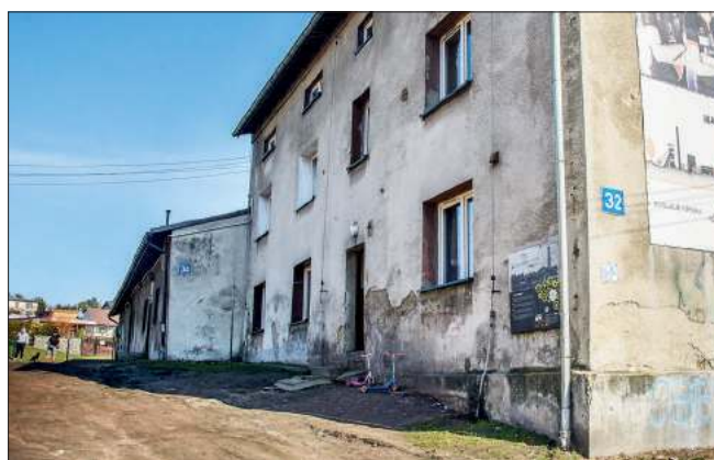
Budynek przy ul. Hallera 32 i 34 w Radlinie jest kiepską wizytówką miasta. Kiepski jest również jego stan techniczny
