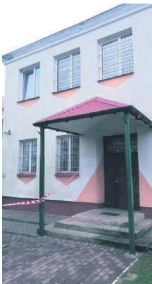
W ubiegłym roku dyrekcja szkoły w Miączynie wygrodziła wejście szarzą, bo odpadł fragment gzymsu.
