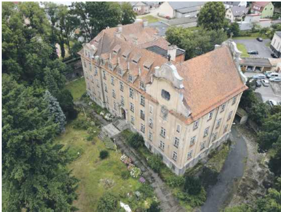
Kupiony za blisko 8 mln zł budynek od prawie 5 lat stoi i niszczeje
