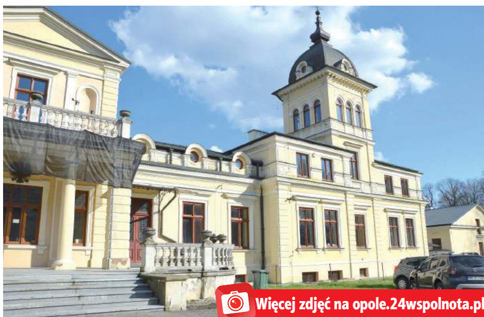
Sam pałac renowację przeszedł kilkanaście lat temu. Ale już wymaga przeprowadzenia kolejnych prac. O naprawę proszą się tynki i detale architektoniczne oraz tarasy
