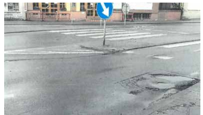
Tuż przy przejściu dla pieszych na Bohaterów Warszawy znajdują się dwie stale powiększające się dziury. Foto. UM Nowogard
