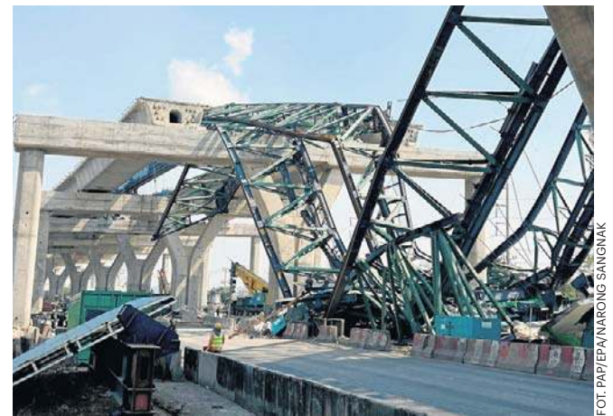
Dźwig zawalił się na budowie drogi w Tajlandii. Zginęły co najmniej dwie osoby
