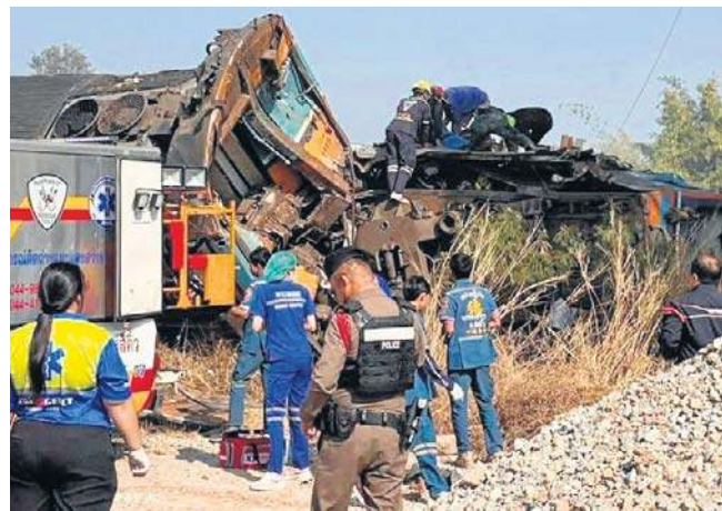
Dźwig pracujący przy budowie trasy kolei dużych prędkości zawalił się i uderzył w przejeżdżający pociąg
