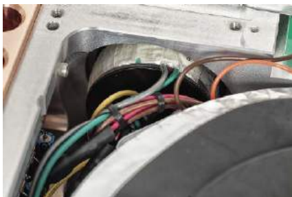
Mniejszy transformator obsługuje układy czuwania.
